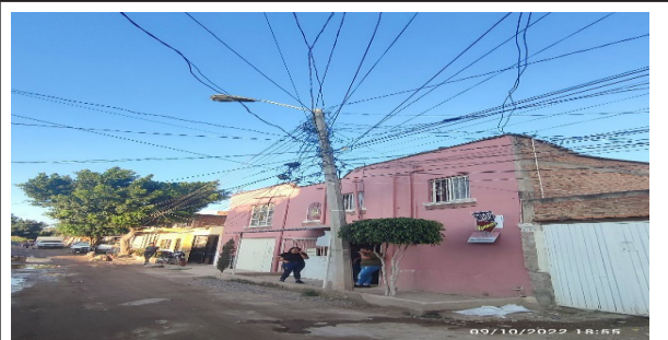
Los habitantes se conectan a un poste de energía eléctrica; el servicio no está regulado. Fuente: Archivo propio. Octubre, 2022
